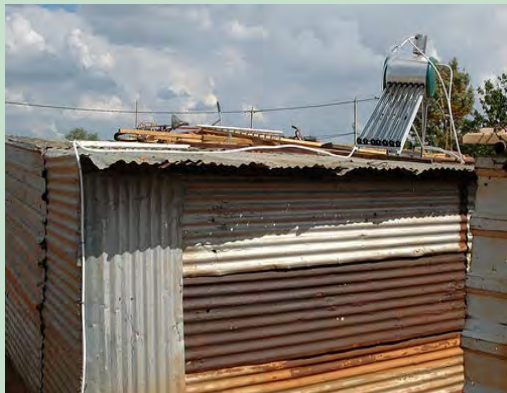
'n Sonkragwaterverwarmer bo-op 'n sinkhuis.
